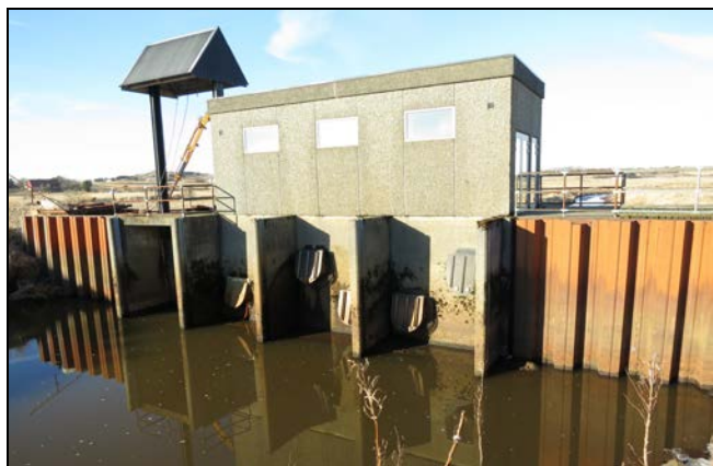
Figur 2. Pumpeinstallasjonen i Skas-Heigre. Foto Bioforsk.
