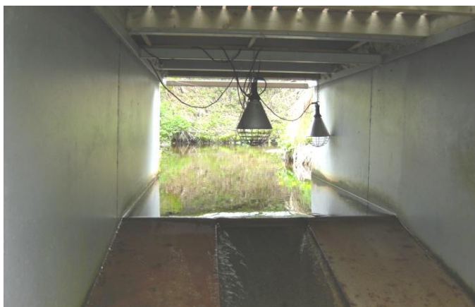
Figur 2. Målerenna - Crump-overløp. Foto: Bioforsk
